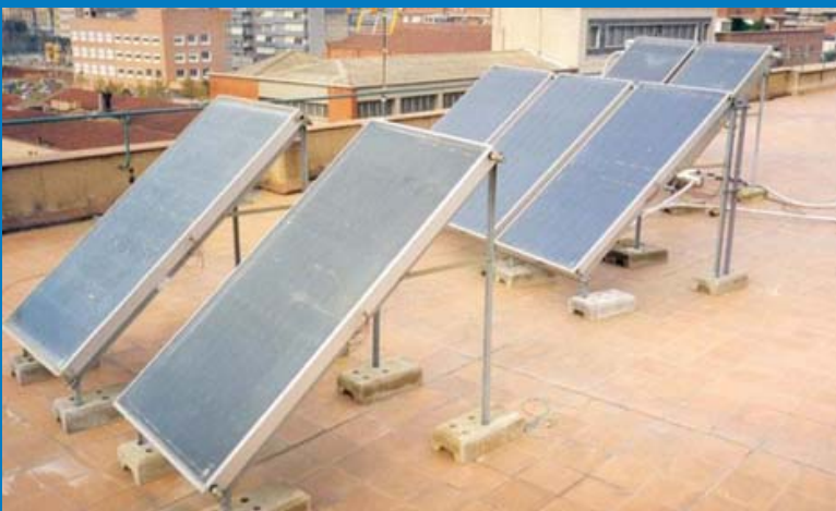
Unitat de testeig de captació solar tèrmic
