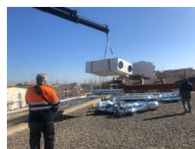
TR8 Substitució 4 recuperadors clima.
