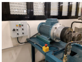
TR4 Laboratori de fluids, quadres de control.
