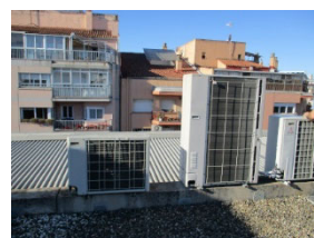
TR8 Recuperació màquina clima del TR10.
