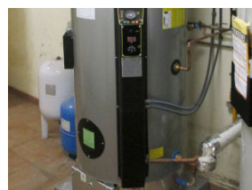
TR5 Substitució caldera- acumulador Serveis esports. PIU
