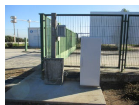
TR45 TR20 i 22 control accés porta principal.
