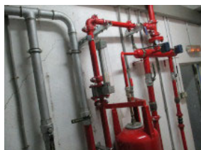
TR11 Instal·lació cabalímetre al grup de pressió. PIU
