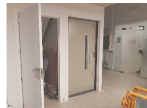
TR1 Ascensor nou a UTG.
