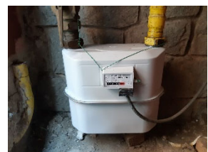
TR10 Comptador gas nou.
