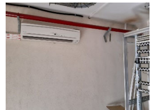
TR6 Clima Rack, màquina nova.
