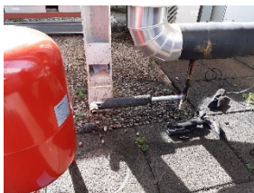
TR14 Substitució vas expansió de calefacció.
