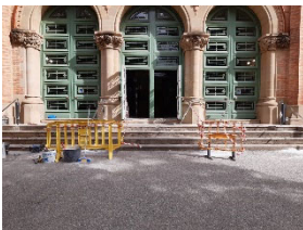
TR1 Reforçar baranes entrada.
